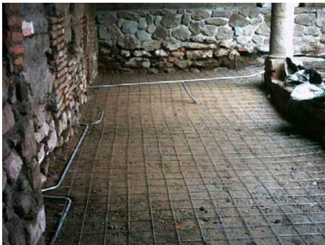
Foto 36. Preparación para fundir el contrapiso en galerías. Vista de muros pelados: piedra de base y calzados con variedad de materiales. Foto M. Hidrobo, 2005.
