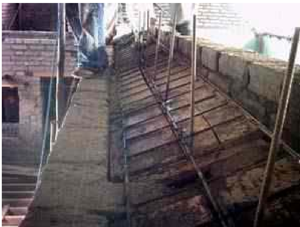
Foto 55. Armado para remate de hormigón en cabeza de muros. Foto M. Hidrobo, 2005
